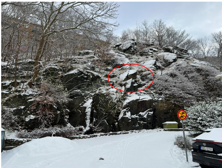
Figur 13: Bild tagen under fältbesök 19/11-2025. Bilden illustrerar bergskärningen vid Djurgårdsplatsen, där ett potentiellt problematiskt block markerat inom röd markering.
