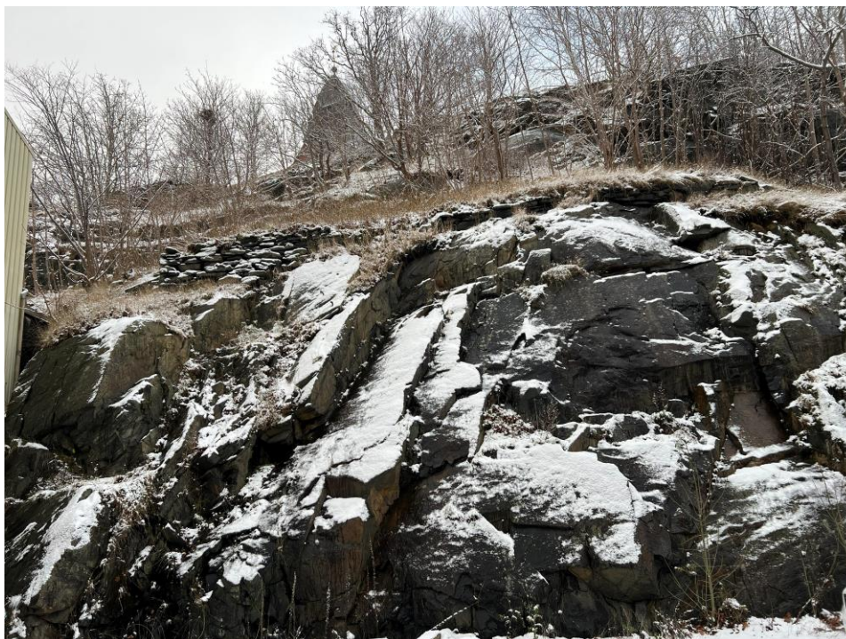
Figur 16: Bild tagen under fältbesök 19/11-2025. Bilden illustrerar delar av bergskärningen som löper längs Bangatan mer exakt vid parkeringen som tillhör Tibergs möbler.
